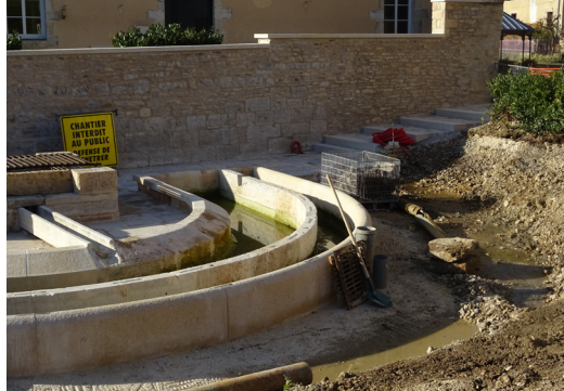
© Agnès Ruffaldi, Soye, chantier de réfection de la fontaine suivi au titre du patrimoine non protégé, octobre 2017,
